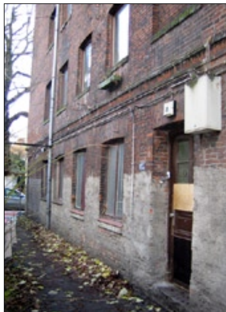
Nach jahrzehntelanger Verwahrlosung: Marode Bausubstanz in der Koppel 46
